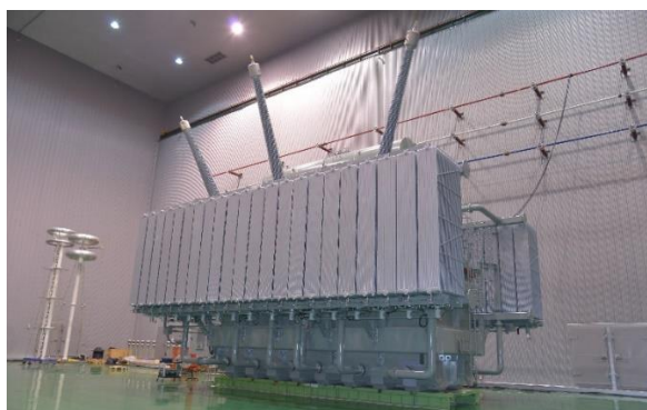
圖 1-3 530kV-775MVA 外銷美國發電廠用昇壓變壓器
