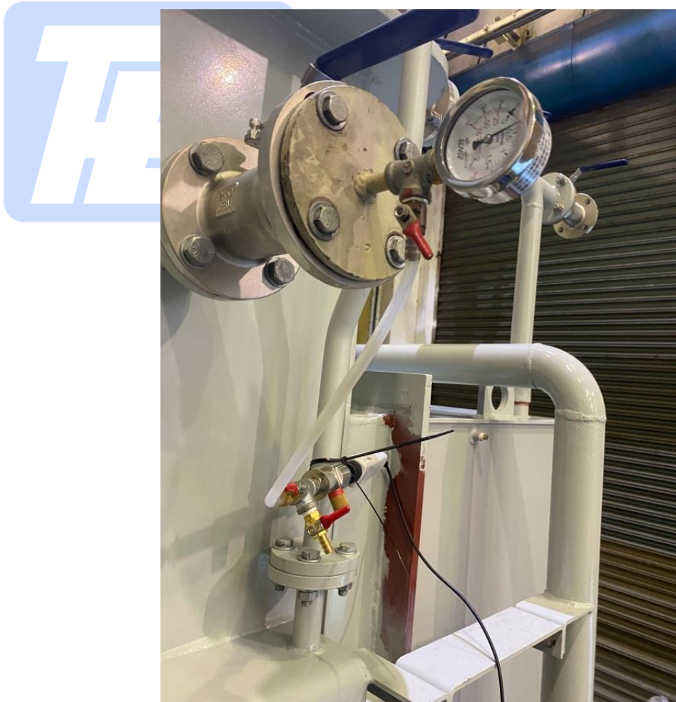
圖 21 儀器無法水平擺放固定於變壓器
