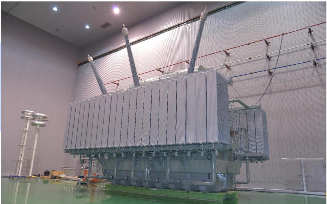
圖 3 530kV-775MVA 外銷美國發電廠用昇壓變壓器
