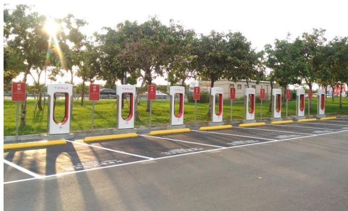
圖 8 直流充電站建置工程 (Tesla 台南奇美博物館超級充電站)
