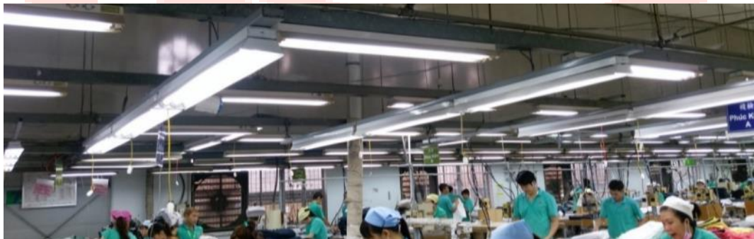
圖 351 後整產線照明設置
